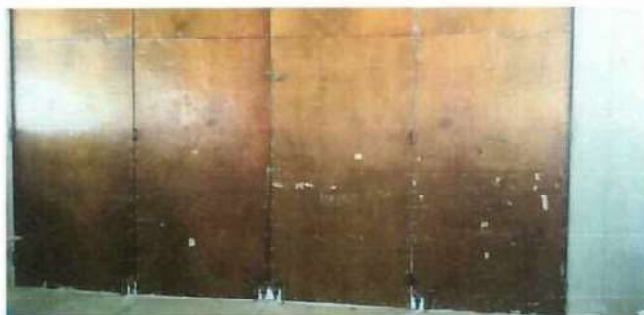
CAMBIO DE DIVISION DE AULAS. SE CAMBIARA LA DIVISION DE LAS AULAS POR EL DETERIORO.
