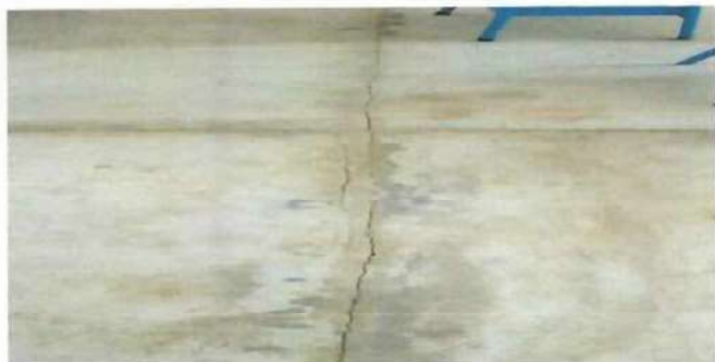
PISO RAJADO. SE NECESITA MANTENIMIENTO DE PISO DENTRO DEL ESTABLECIMIENTO EDUCATIVO. COLOCAR PISO CERAMICO.
